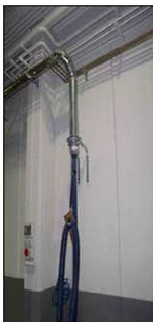
Extractor de gases simple
